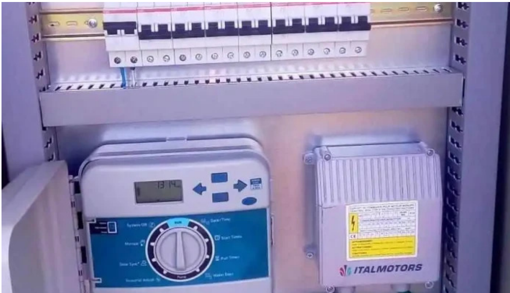
Gelectric instalaciones interior
